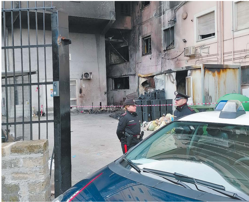
Sequestro Sigilli all'intera struttura sulla quale si stanno eseguendo analisi per la stabilità
